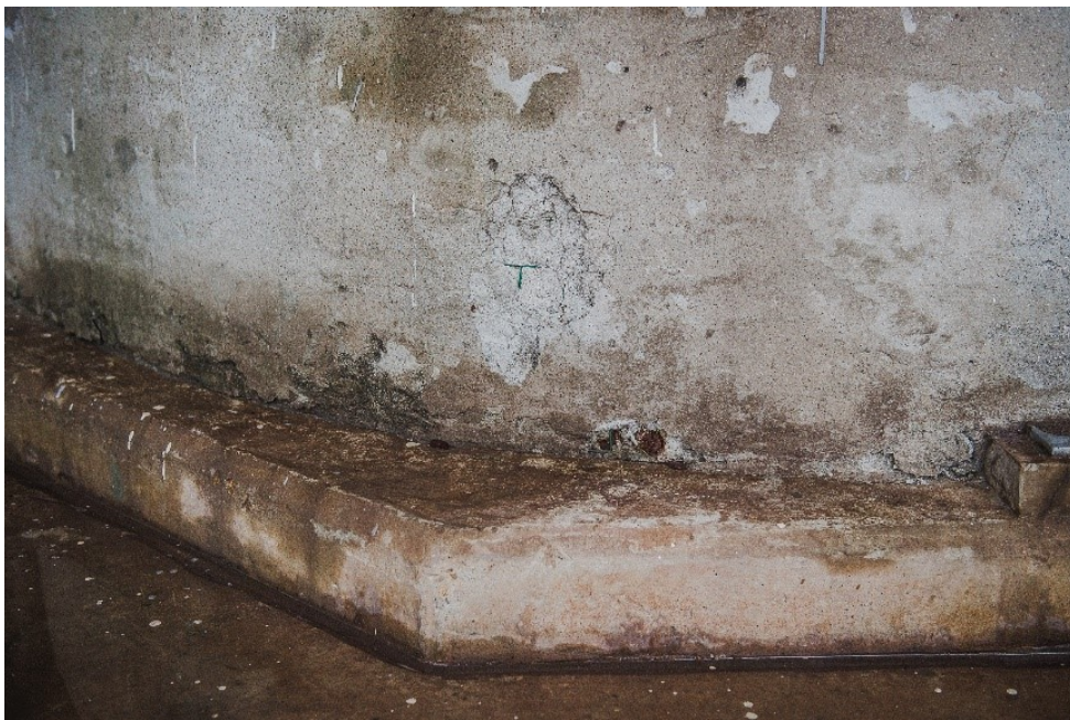
Schade aan passieve brandbeveiliging van beton
